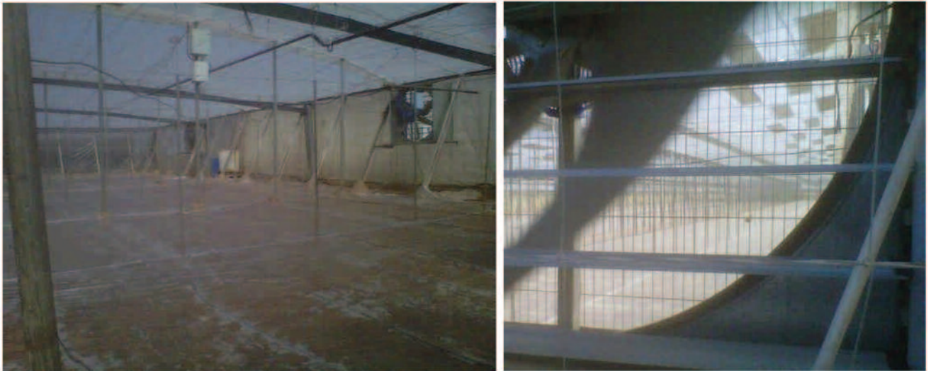
Ventilación forzada instalada en el invernadero
